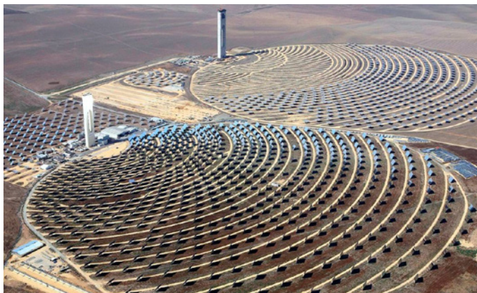
Figura 2.1. Centrais solares de torre central localizadas en Sanlúcar la Mayor (Sevilla). Fonte: Wikimedia Commons baixo licenza cc-by-3.0
