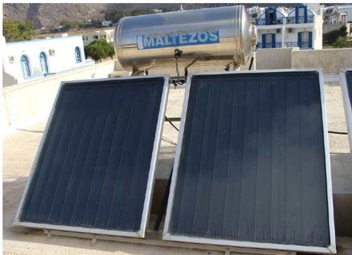
Figura 2.4. Colector de capa plana e depósito de auga instalados sobre unha terraza. Fonte: Wikimedia Commons baixo licenza cc-by-sa-3.0
